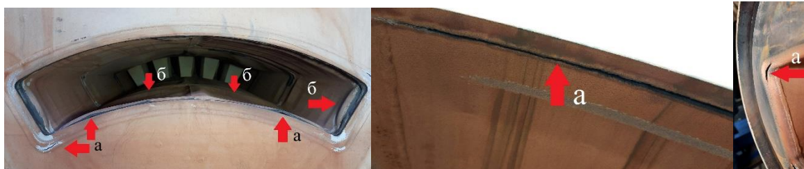
Рис.2 – Дефекты в узле переходник: а – трещины; б – деформация.
